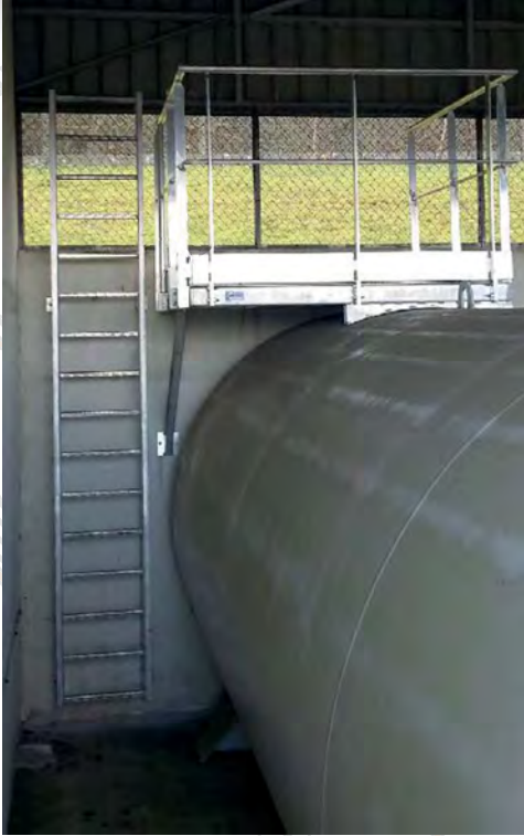
Passerelle Alu sur cuve (Rouen)
